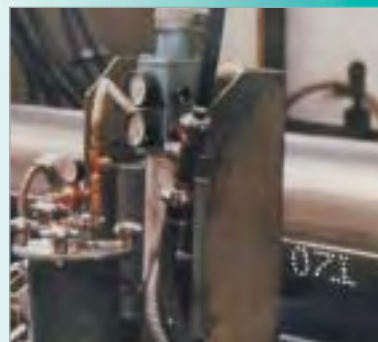
Signierung von Rohren
